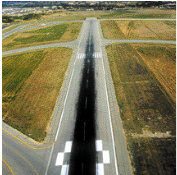
Aéroport de Marseille-Provence. Gomme déposée sur la piste
