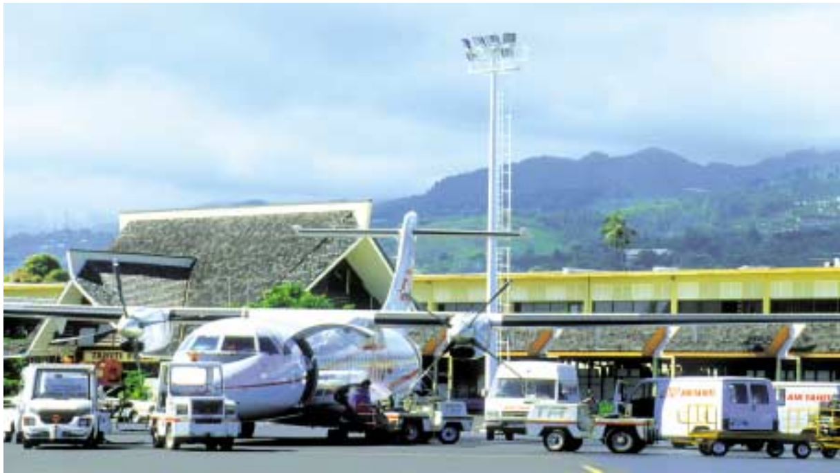
Aéroport de Tahiti-Faaa - Dispositif d'éclairage de l'aire de stationnement
